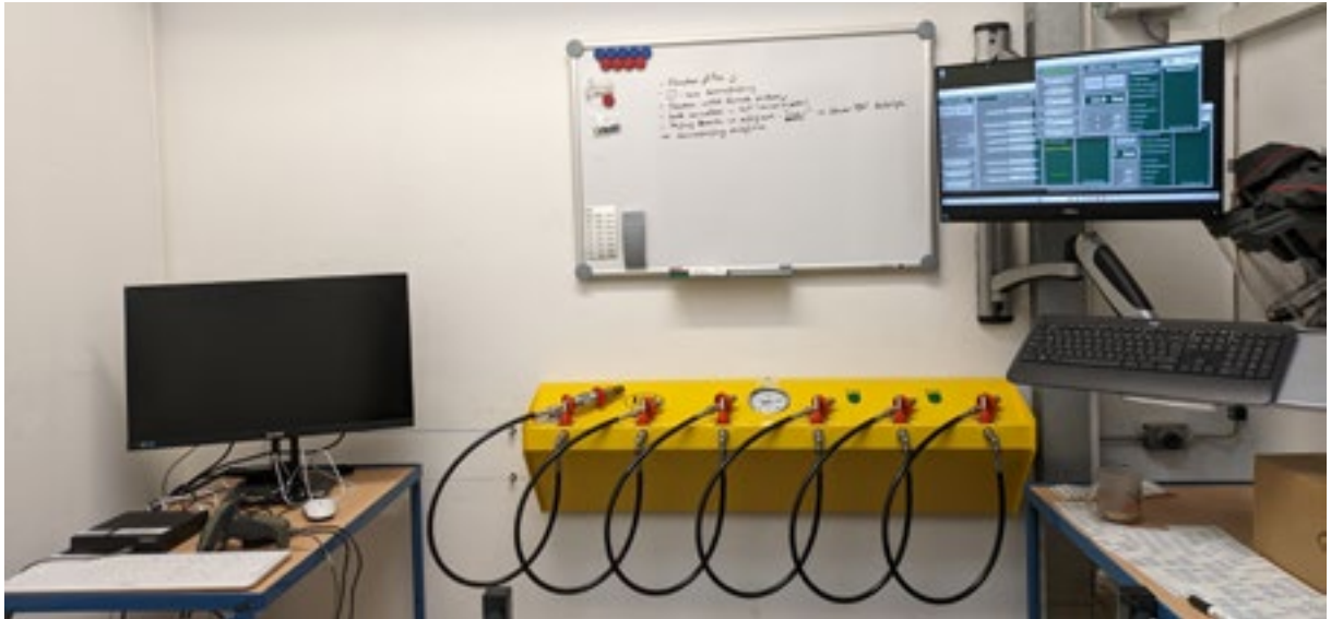
Bild 4 – Überwachung und Füllstation
