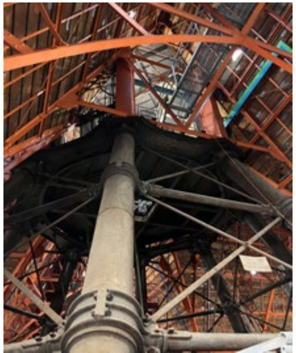
Bild 2: Die Vierung. Hier laufen in Summe vier Kirchenschiffe im Dachbereich zusammen. Die gezeigte Dachkonstruktion stellt einen besonders schützenswerten Knotenpunkt dar.
