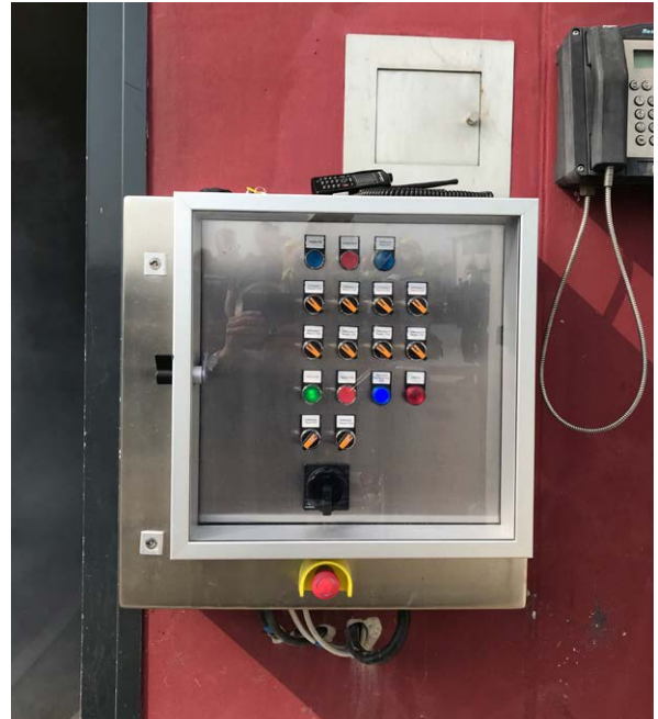
Steuerungseinheit Verrauchung Kaltseite (Foto: Feuerwehr Dortmund)
