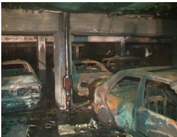
Blick in die kalte Brandstelle – das Feuer hat zahlreiche PKW zerstört
